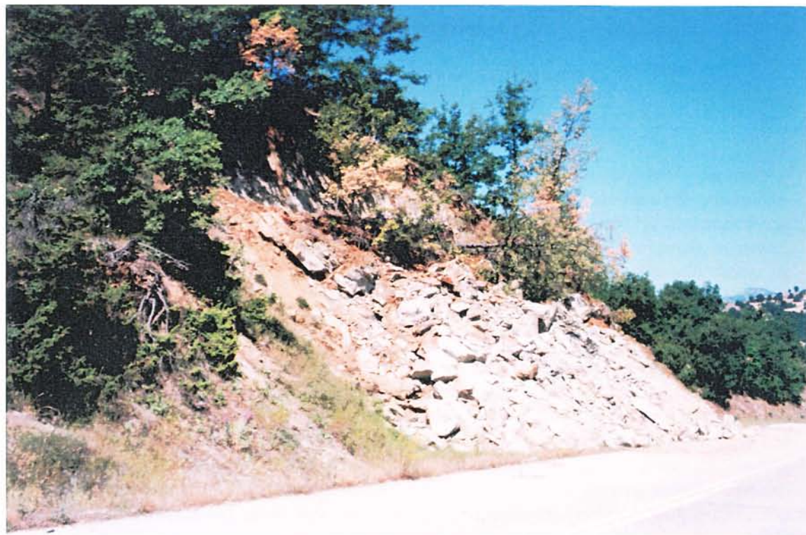
Εικ. 4-8. Κατολίσθηση στον επαρχιακό δρόμο Καλλονής-Τρίκορφου.
